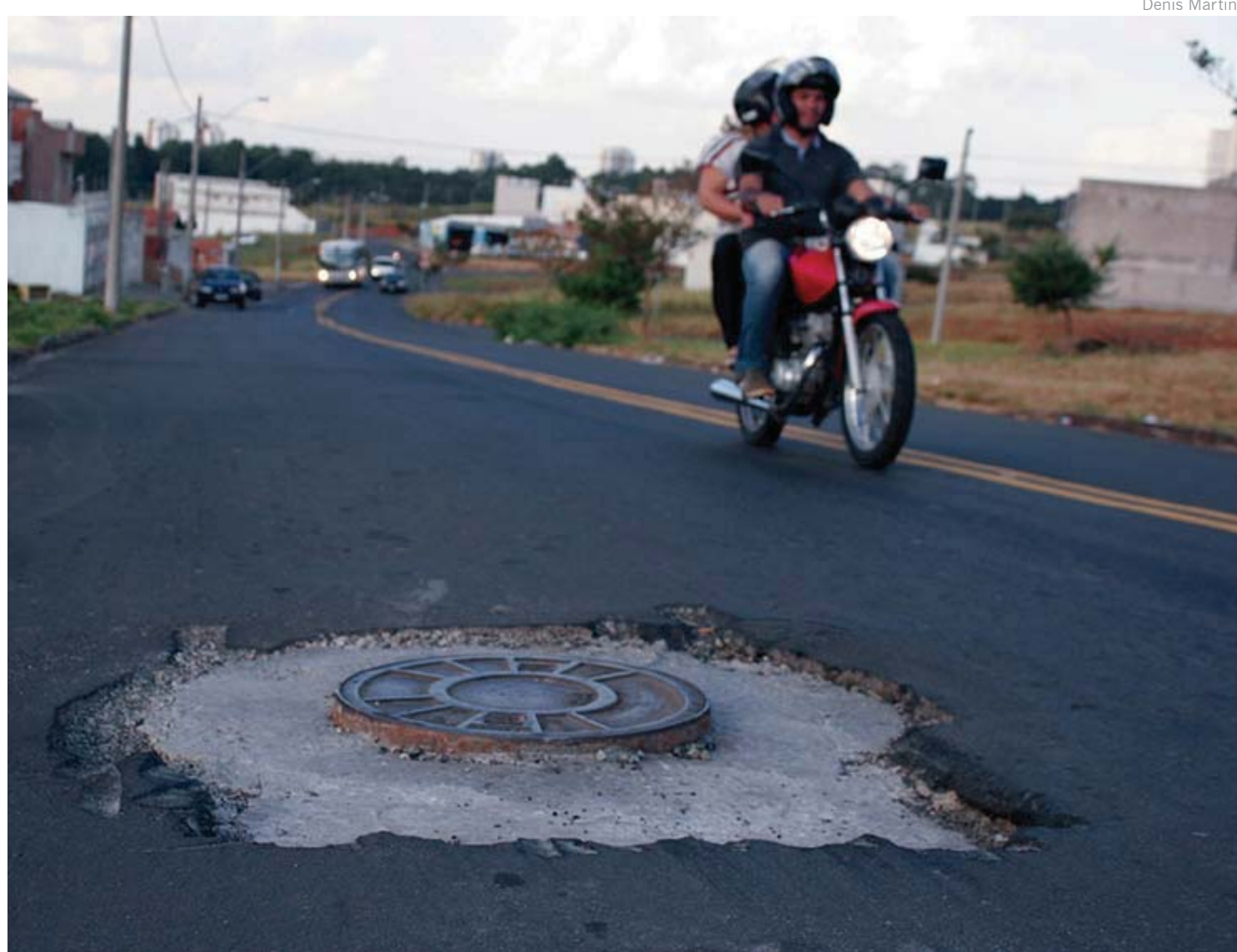
Ao todo, Rua Mário Soares de Campos, na Cidade Universitária, tem seis tampas de bueiros que estão em desnível com o asfalto
